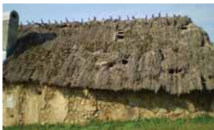
Slamená strecha havarijný stav
